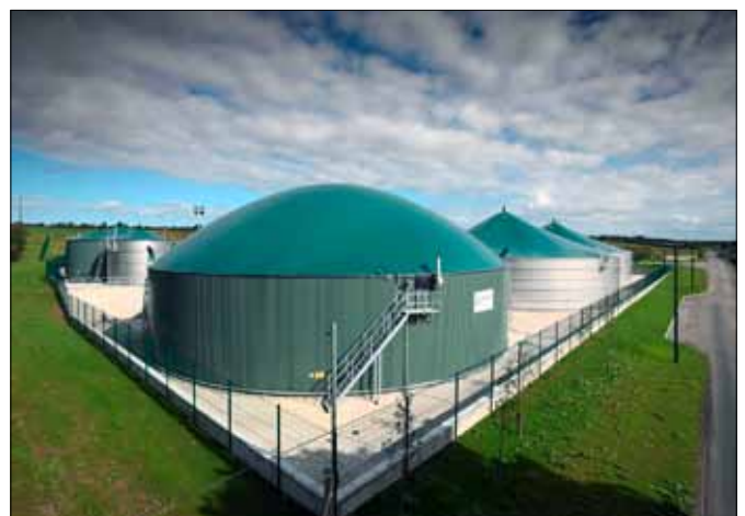
Die beiden 3.573 Kubikmeter großen Fermenter aus Edelstahl in Aurora werden täglich mit 100 Tonnen organischer Reststoffe gefüttert.
