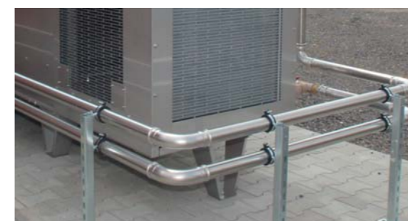
Effizient: Die Vorlauftemperatur des Heizkreislaufes erreicht bis zu 85 Grad Celsius.
