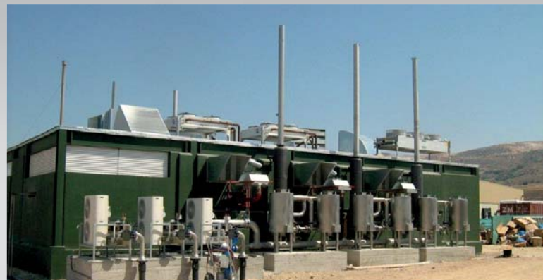
Sieben BHKWs mit einer Gesamtleistung von 1,8MWh generieren Strom aus dem Biogas
