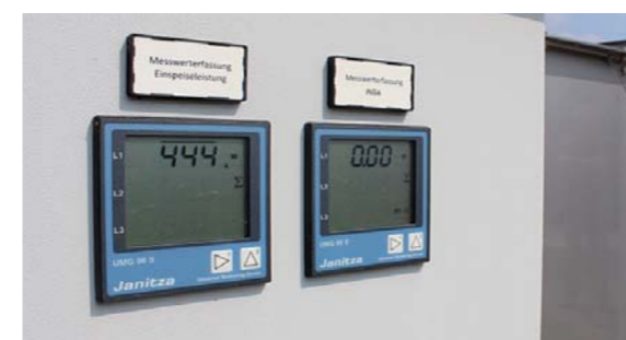
Übersichtlich: Von außen ist die Einspeiseleistung und die Leistung von INSA immer schnell auf einen Blick ersichtlich.
